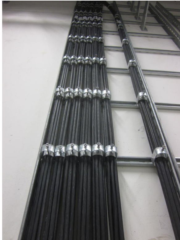
Abbildung 10: Beispiel Kabelverlegung im Steigbereich
